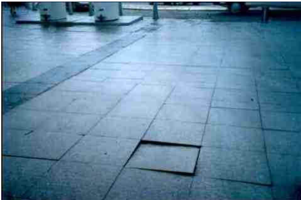
Estefânea – piso inadequado
